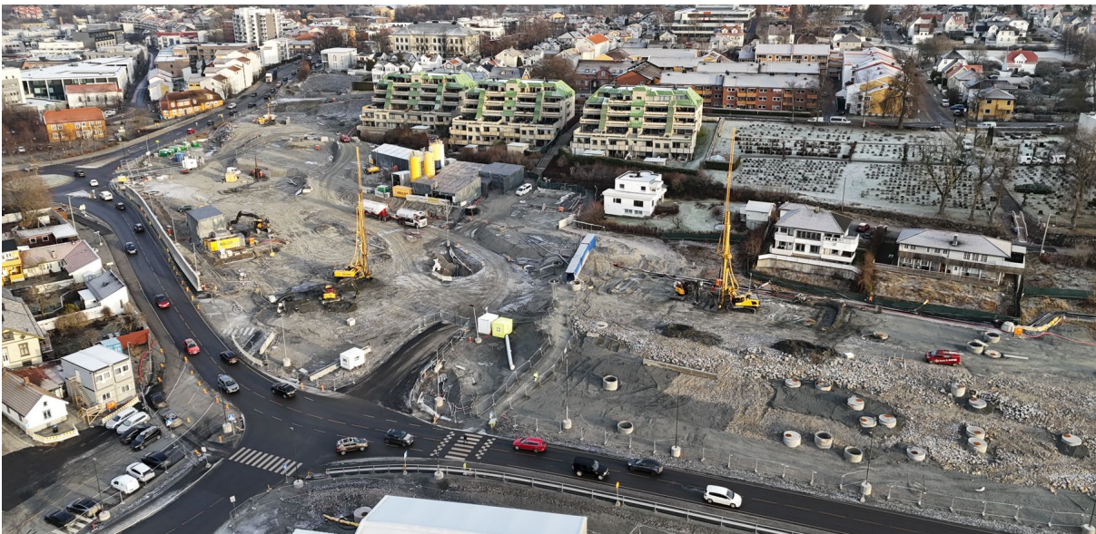
Figur 3. Jetpeling i Kransen Nord anleggsområde og ved Fjordveien, desember 2024. Foto: Bane NOR.
