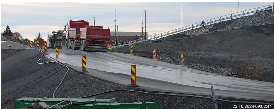
Figur 12. Anleggsvei gjennom anleggsområdet i Sentrum hvor støvdemping er etablert (perforert vannledning). Foto: Bane NOR.
