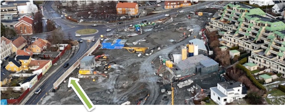
Figur 23. Bildet viser støyskjermen som er satt opp langs Fjordveien for å dempe støy fra anleggsområde Kransen Nord. Foto: Bane NOR.
